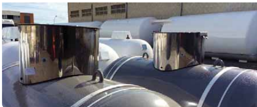
ARQUETAS DEPÓSITOS ENTERRADOS
